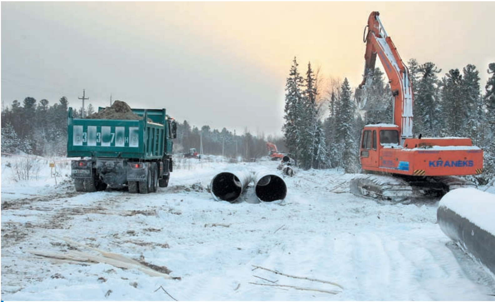
Капитальный ремонт газопровода Парабель – Кузбасс: в этом месте трасса пересекает бесчисленное множество рек, ручьёв и болот
