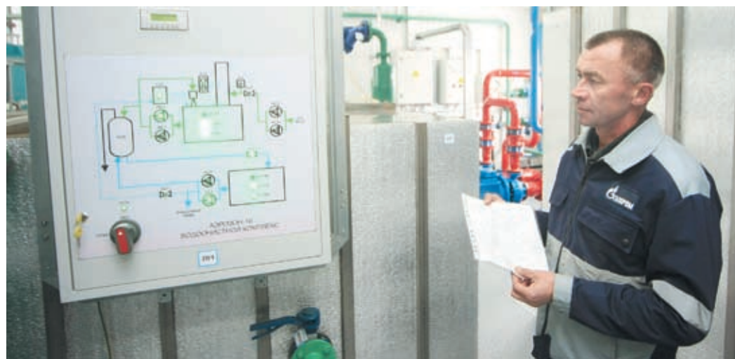
Юргинское ЛПУ: пульт управления новой станцией водоподготовки
